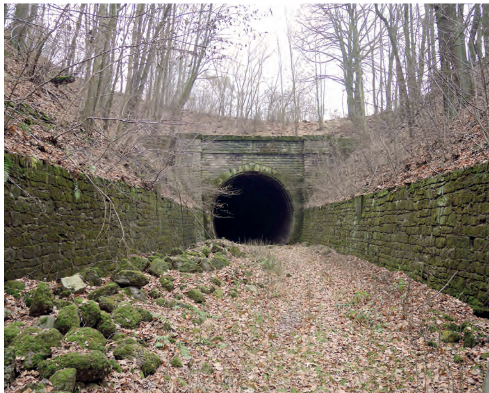
Tatenice, železniční tunel Tunel na trase olomoucko-pražské dráhy, opuštěný po napřímení trati mezi Zábřehem na Moravě a Krasíkovem, byl fotograficky dokumentován v souvislosti s průzkumem Severní státní dráhy. Foto Michaela Ryškova, 2016.
