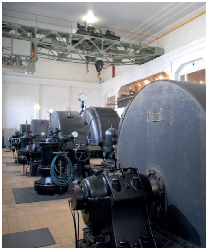
Zachování průmyslového dědictví – zachování původní funkce Ovre Eiker (Norsko), elektrárna Hakavik
